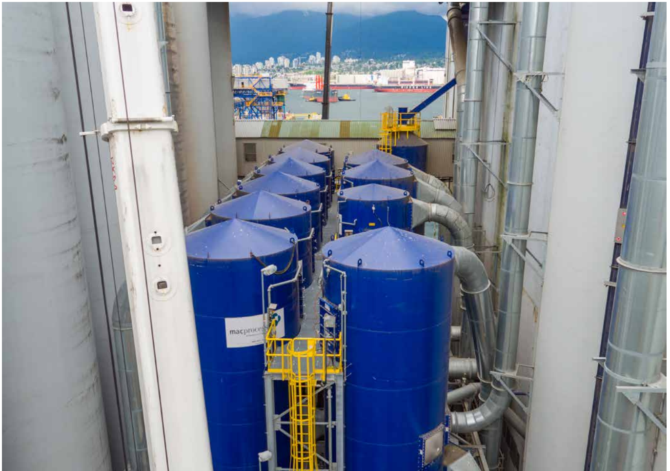
Abbildung 2: Viterra installierte ein MCF-PowerSaver-Staubfiltersystem in zwei Getreideverarbeitungsterminals.
